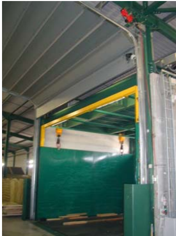
Automatisch openen/sluiten van de poorten, met vergrendeling én controle op vergrendelde toestand.
